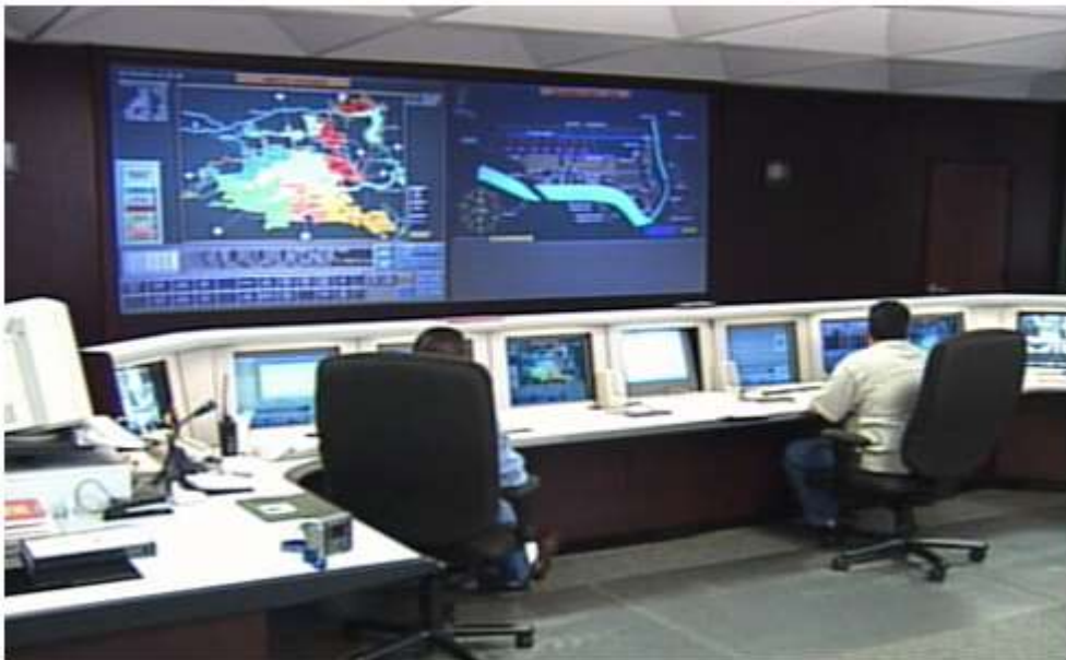
Gambar 1.4 Sebuah Master Control Room untuk mengontrol Sistem Proses
